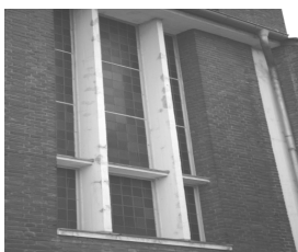
An allen Betonsprossen bröckelt der Beton
